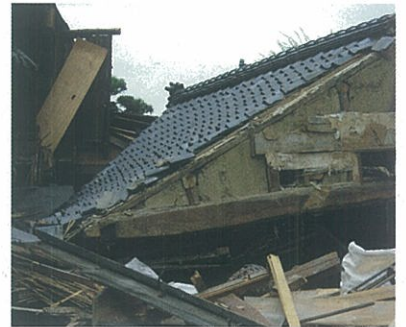
阪神・淡路大震災による被害
