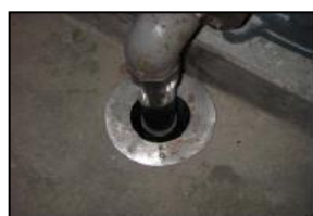
揚水管の隙間
