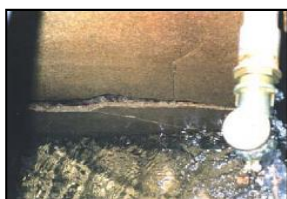
水槽内壁に亀裂あり
